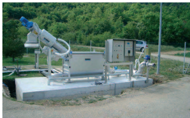
Зарекомендовавшие себя компоненты предварительной механической очистки, объединенные в установке ROTAMAT® Ro 3.3
