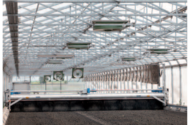
El dispositivo de volteo de lodo en su recorrido a través del invernadero
