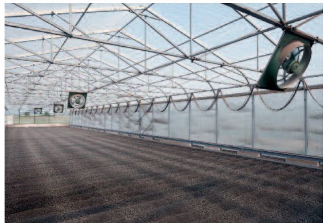
Los ventiladores soplan aire a través de la cama de secado
