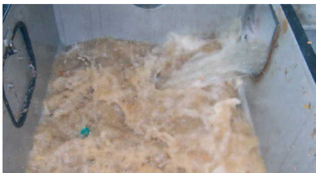
Debido al accionamiento de un agitador se genera una gran turbulencia en el tanque de lavado.
