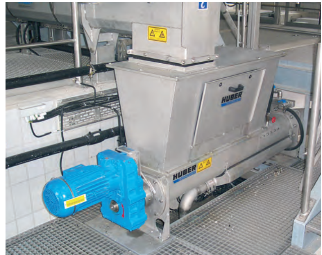
采用 WAP 装置安全可靠地进行栅渣处理
