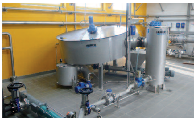
过滤液储存箱和冲洗水泵，用于冲洗水循环利用
