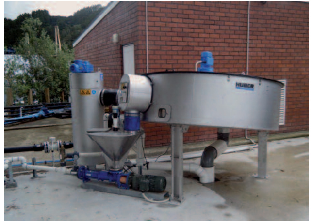
浓缩转盘机RoS 2S在室外安装
