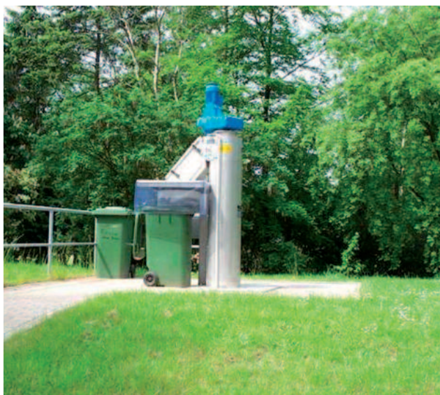
室外安装，配置保温加热系统
