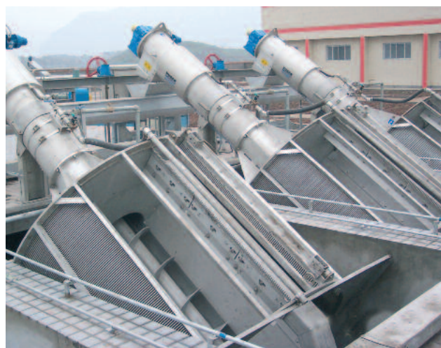
ROTAMAT® 细格栅 Ro 1 在沟渠内多台并联安装
