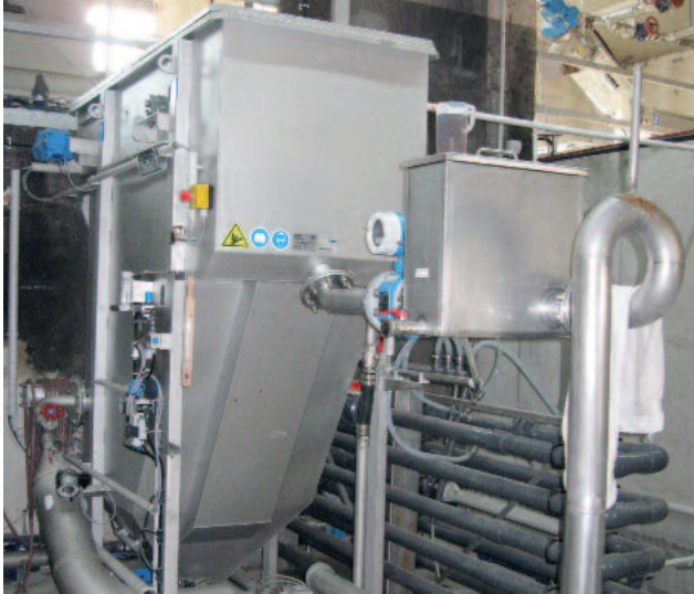
Abwasserbehandlungsanlage Lederindustrie Deutschland: HUBER Druckentspannungsflotation HDF
