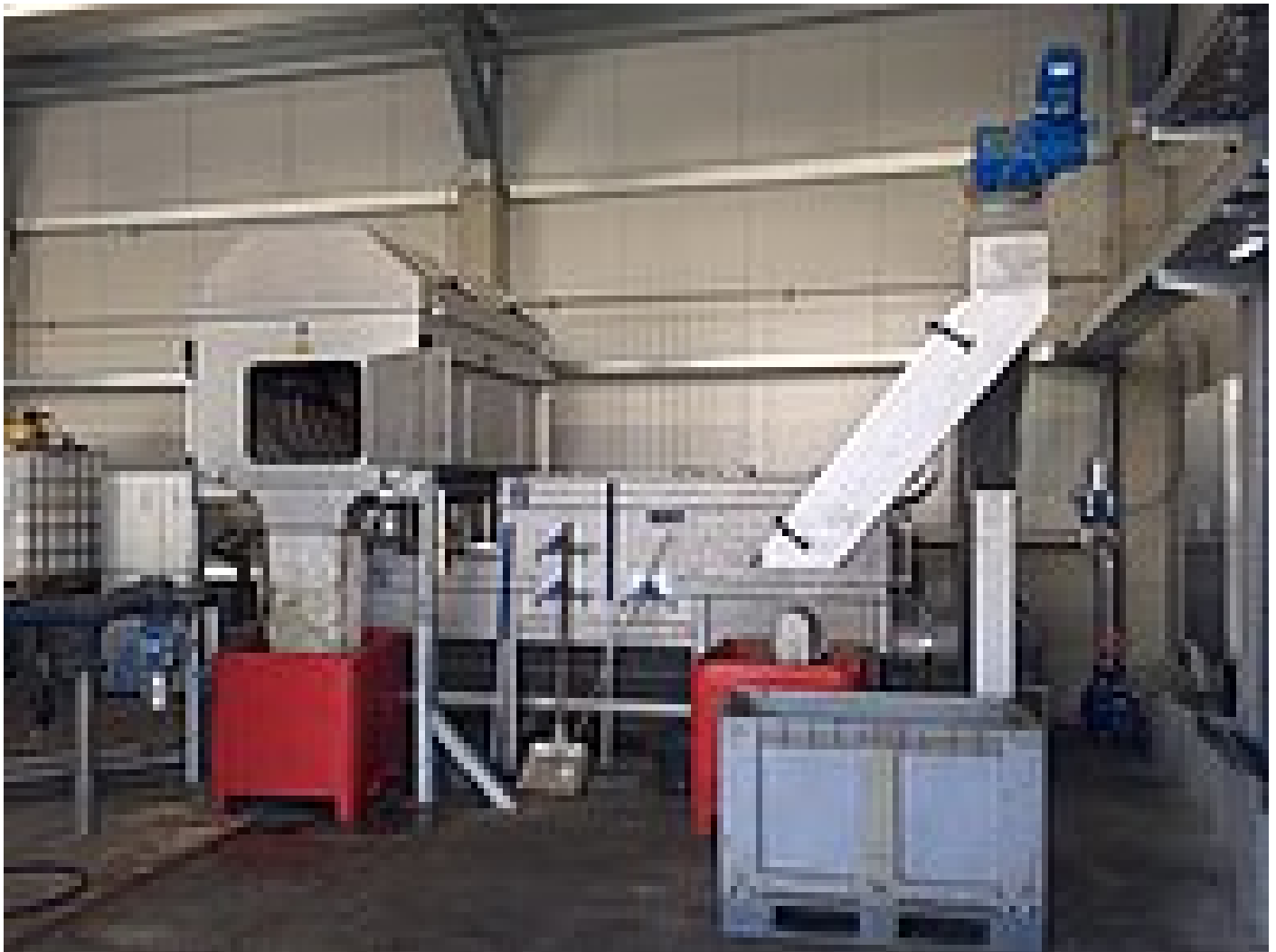
Tamiz de tambor HUBER RoMesh® 3 y desarenador longitudinal HUBER ROTAMAT® Ro6 30 con sistema de remoción de grasas
