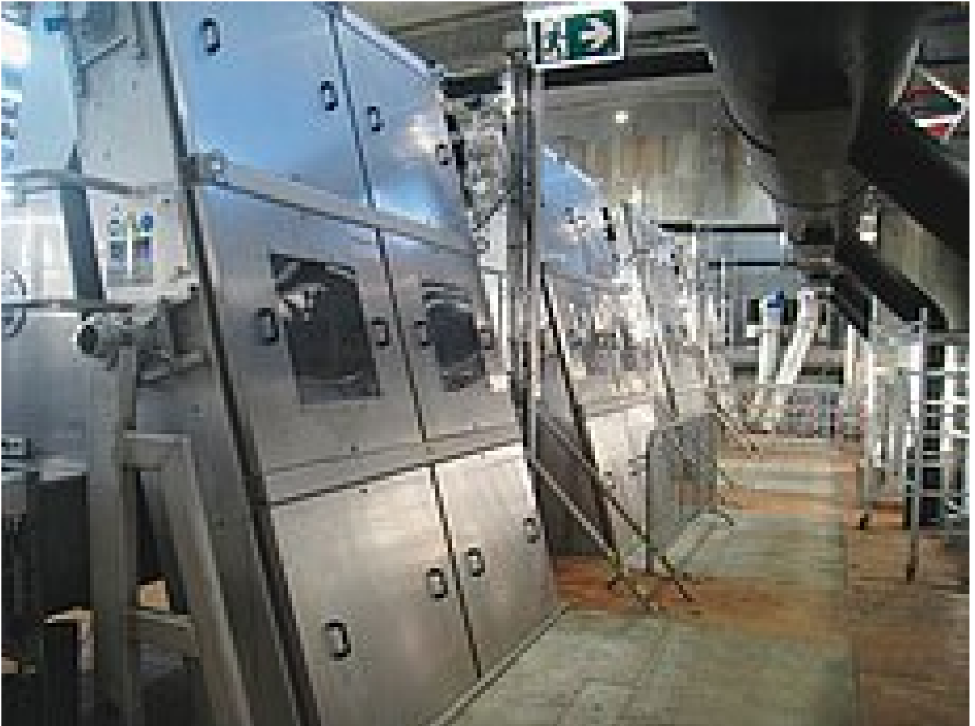
Tecnología de máquinas HUBER de última generación en la depuradora más grande de la Alta Austria, en Linz-Asten
